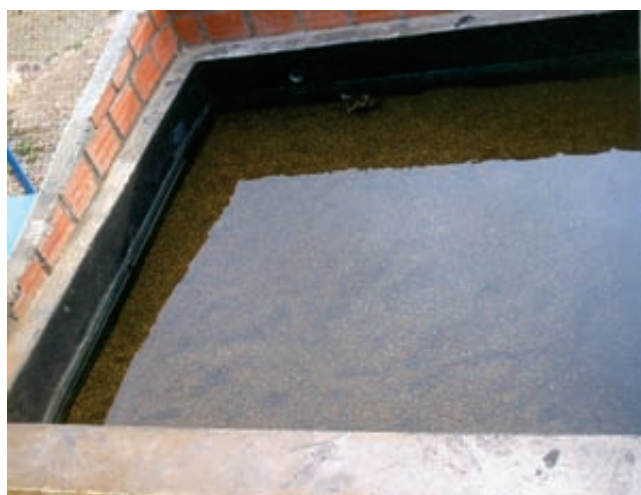
Foto 1. 2 Filtro de grava de flujo ascendente
