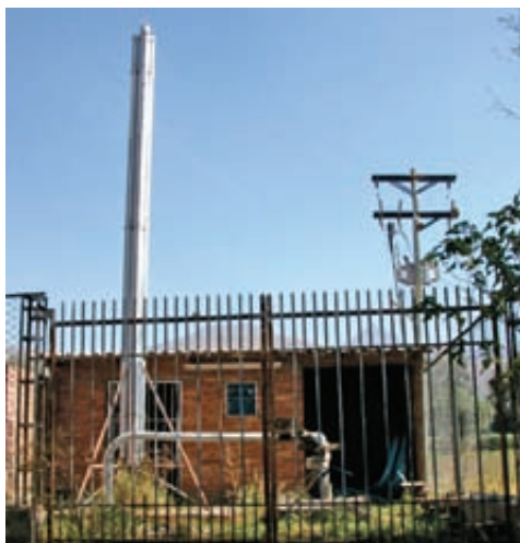
Foto 3. Torre Hidroneumática Clásica
