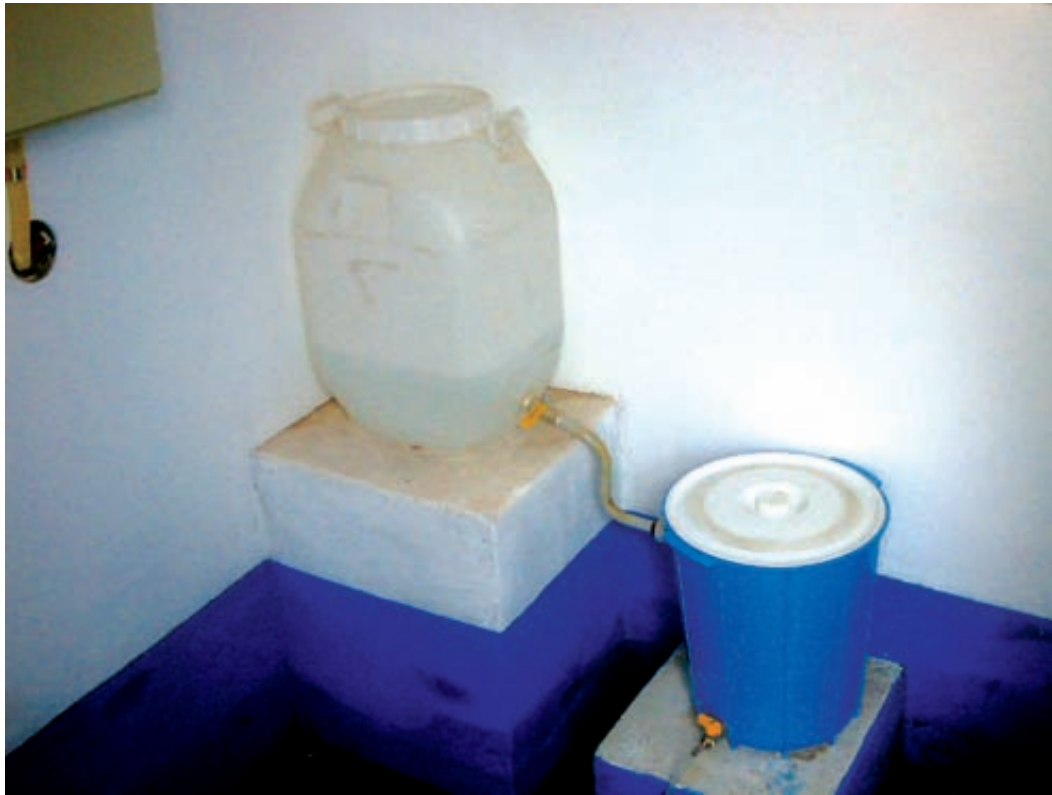
Foto 1.1 Hipoclorador en funcionamiento, Municipio Sica Sica, Localidad Panduro
