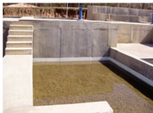
Filtro Grueso Ascendente Loc. Villamontes
