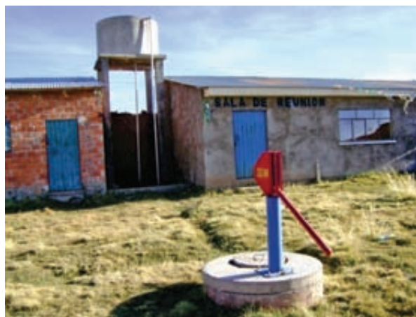
Foto 2.2. Bomba Wara de elevación Comunidad: Tambillo-módulo lechero
