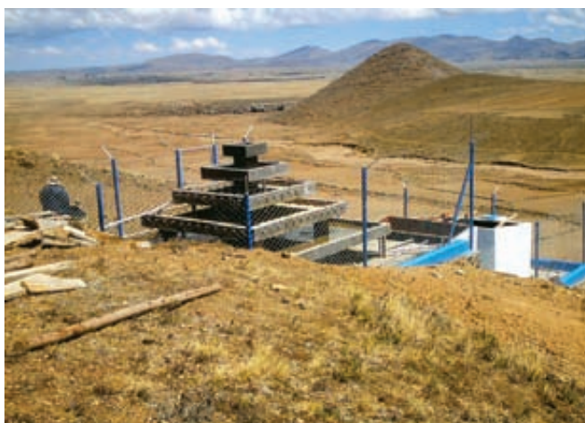
Foto 1.1 Aireador y Filtros localidad de Tahari Municipio de Achacahi
