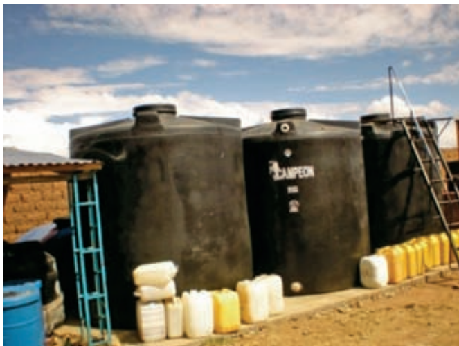
Foto 1.1 Tanque tipo cilíndrico 5 m 3
